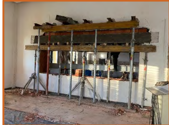
Mehrzweckraum mit Durchbruch:
