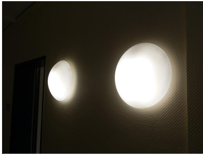
Flur – Verwaltung/Leuchten mit Kompaktleuchtstofflampen
