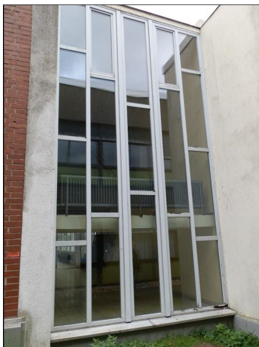
Treppen/Verglasung mit Holzrahmen, z.T. schadhaft
