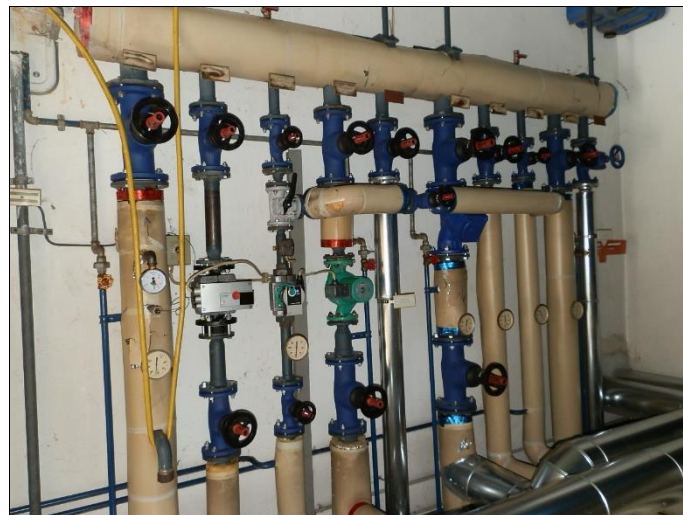
Absperrventile ohne Dämmung
