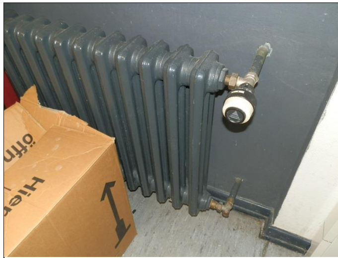
Klassenraum/Heizkörper mit Thermostatventile ohne Voreinstellung
