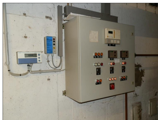
Regeltechnik im Heizraum
