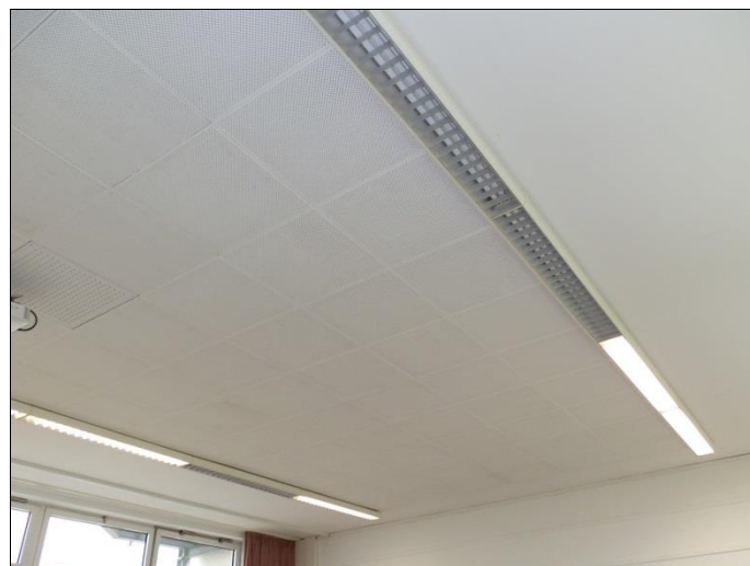
Klassenraum/Rasterleuchten mit T8-Lampen und EVG
