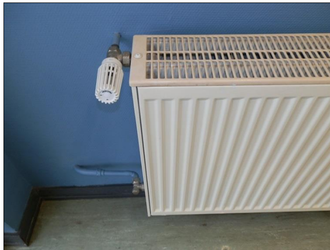
Altbau/Radiator mit Thermostatventil
