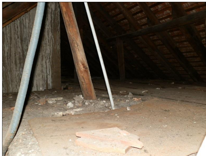
Oberste Geschossdecke ohne Dämmung, marode
