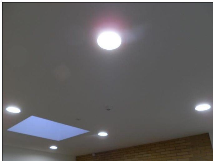
Eingangsbereich/neue LED-Leuchten mit Bedarfssteuerung über Präsenzmelder
