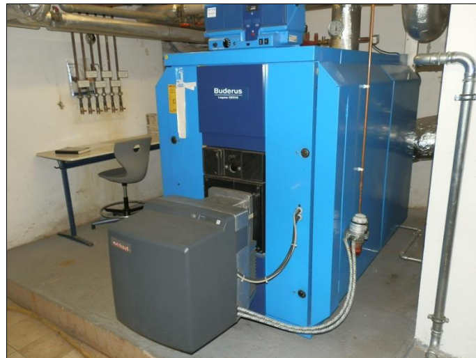
Schule/Niedertemperaturkessel mit Heizölfeuerung
