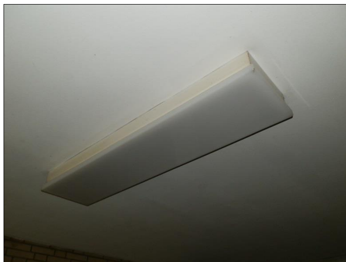
Sporthalle – Umkleideraum/stark veraltete Langfeld- leuchte
