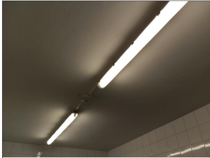
Hauptgebäude/Außentoiletten, Leuchten mit T8-Lampen
