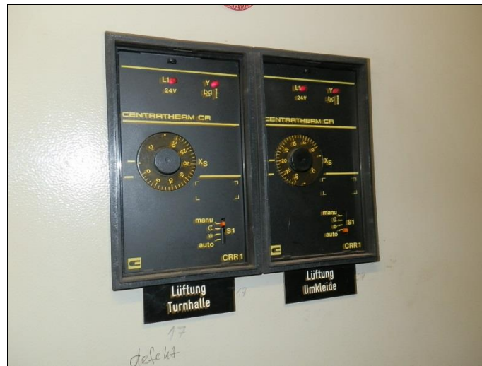
RLT-Anlage Halle/veraltete, defekte Regelmodule
