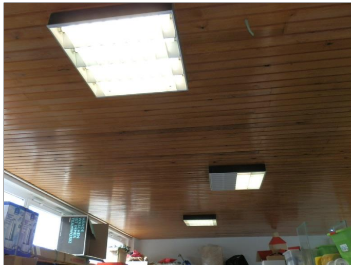
Altbau – Materialraum/stark veraltete Anbauleuchten
