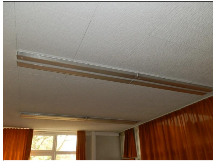
Hauptgebäude/Klassen-Nebenraum, stark veraltete Anbauleuchten
