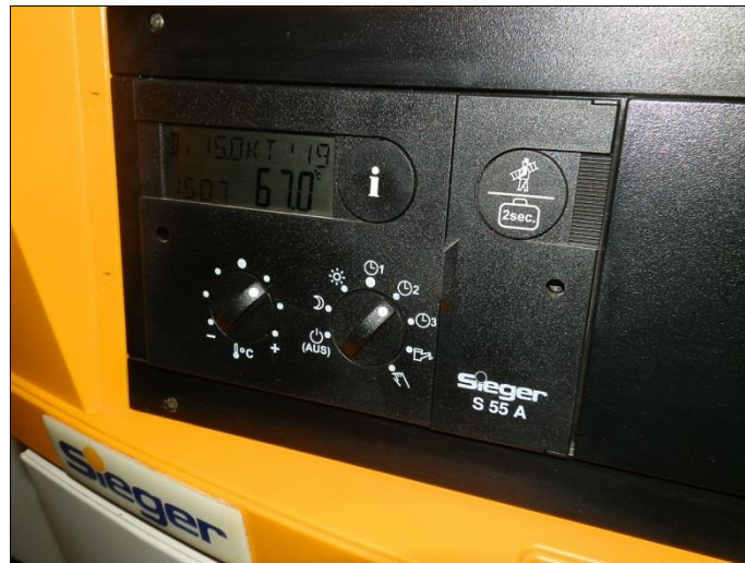
Regeltechnik am Kessel
