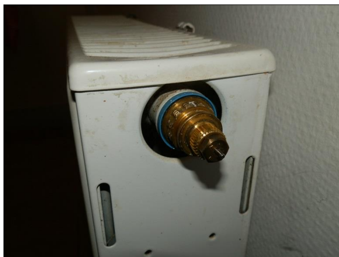
Ventilheizkörper mit Thermostatventil ohne Voreinstellung
