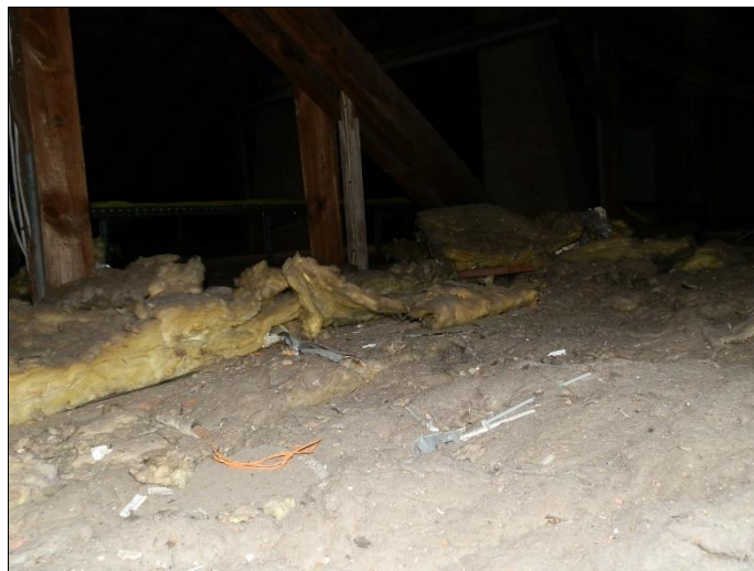
Alte und schadhafte Dämmung der obersten Geschossdecke
