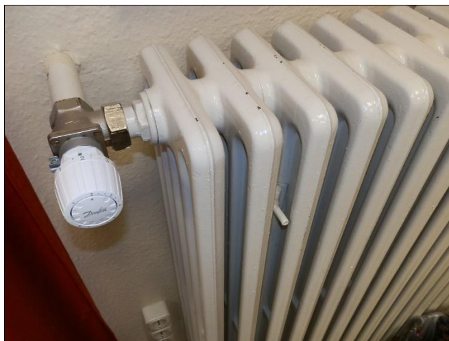
Altbau/Thermostatventil ohne Voreinstellung
