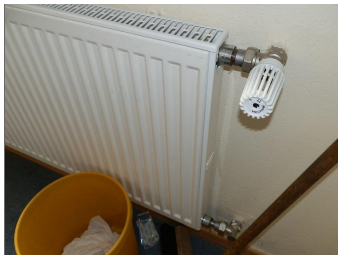
Radiator mit fest eingestelltem Thermostatventil
