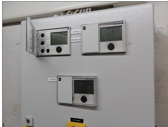
Heizungsunterstation Gebäude B/Regeltechnik
