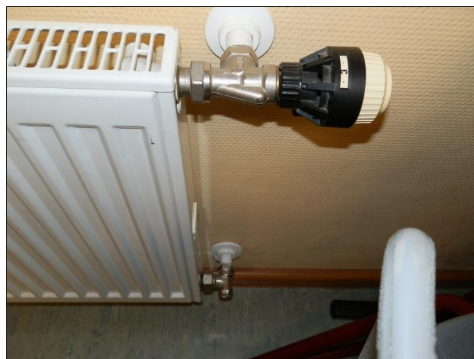
8-Klassen-Bau / Thermostatventil ohne Voreinstellung
