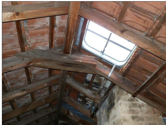
Hauptgebäude/Schäden am Dach/Eindeckung, den Anschlussbereichen Kamin und Fenster
