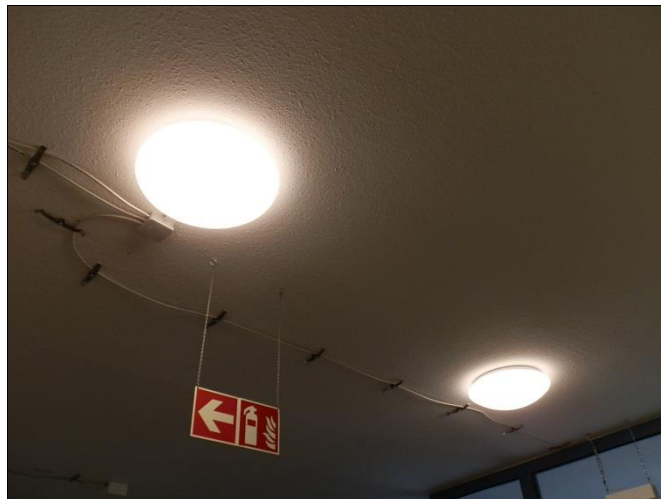
Altbau / neue LED-Leuchten
