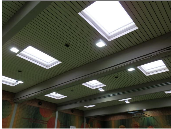
Hallenbeleuchtung mit HQI-Lampen
