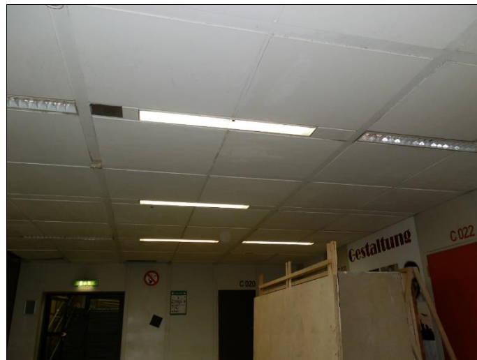
UG/alte Einbauleuchten, Sanierung für 2020 geplant
