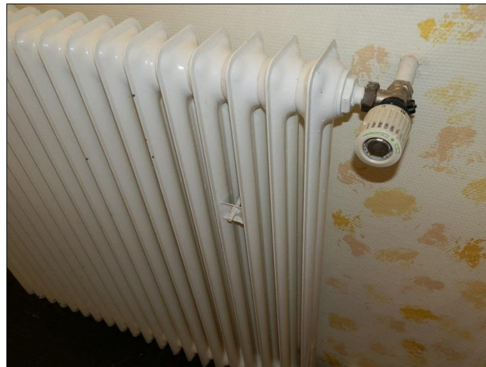
Verwaltung / altes Thermostatventil
