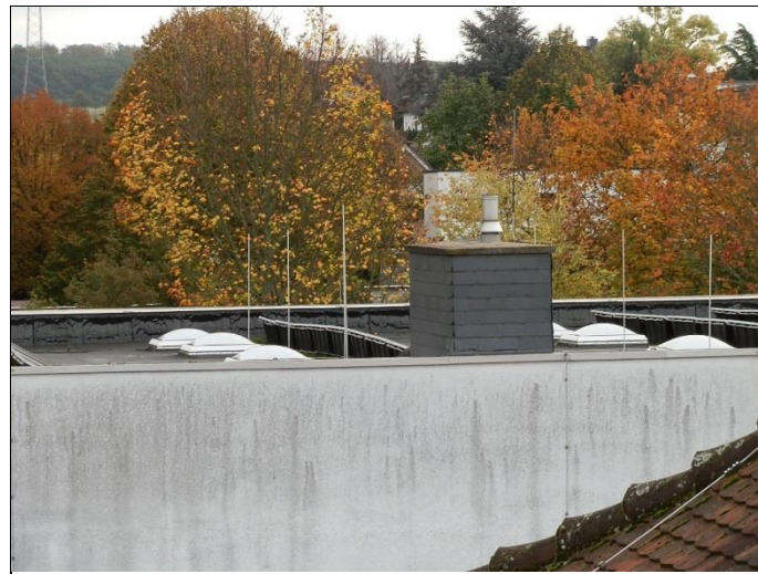
Hauptgebäude/bestehende Photovoltaikanlage der OVAG
