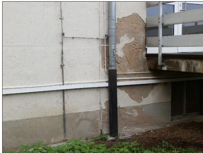
Schäden an der Fassade, Sockelbereich teilweise ohne Farbe und Putz
