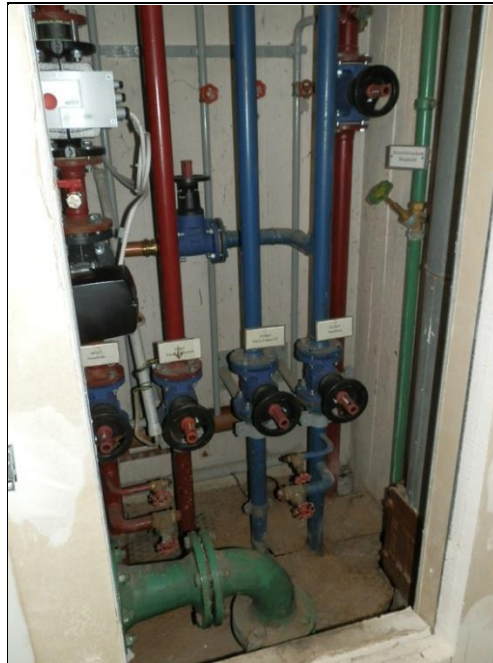
Hauptgebäude – Unterstation/Leitungen und Absperrventile ohne Dämmung
