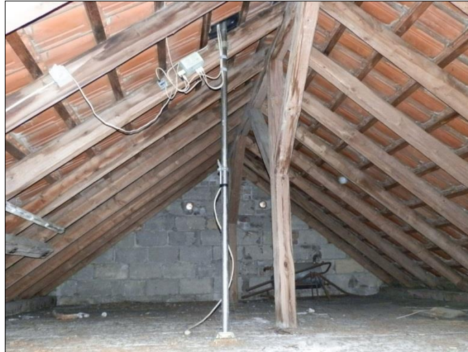
Oberste Geschossdecke/Dach ohne Dämmung
