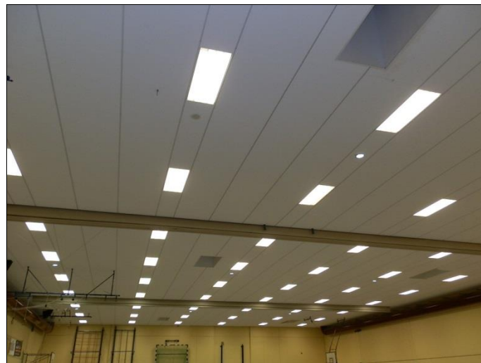
Hallenbeleuchtung mit T8-Lampen und EVG
