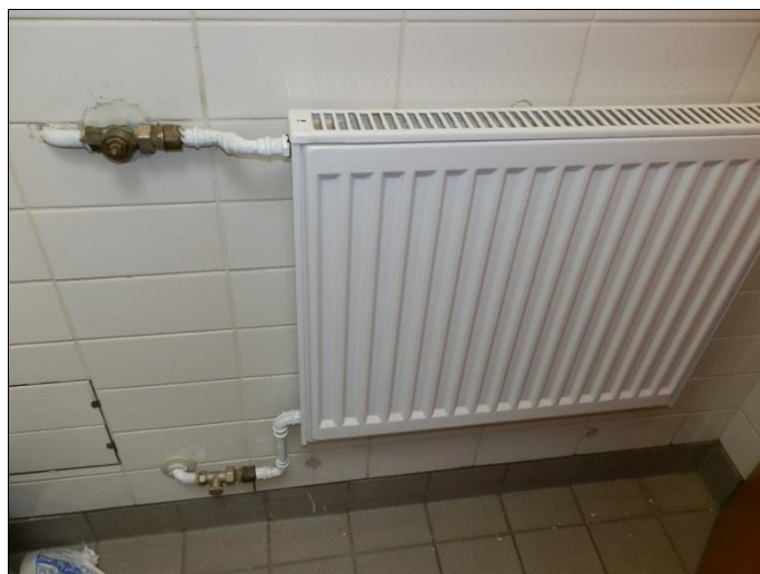
Hauptgebäude/Toilette, fehlendes Thermostatventil
