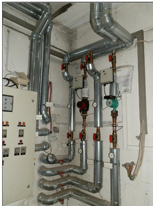
Sporthalle Anbau/Heizungsverteilung, Umwälzpumpen
