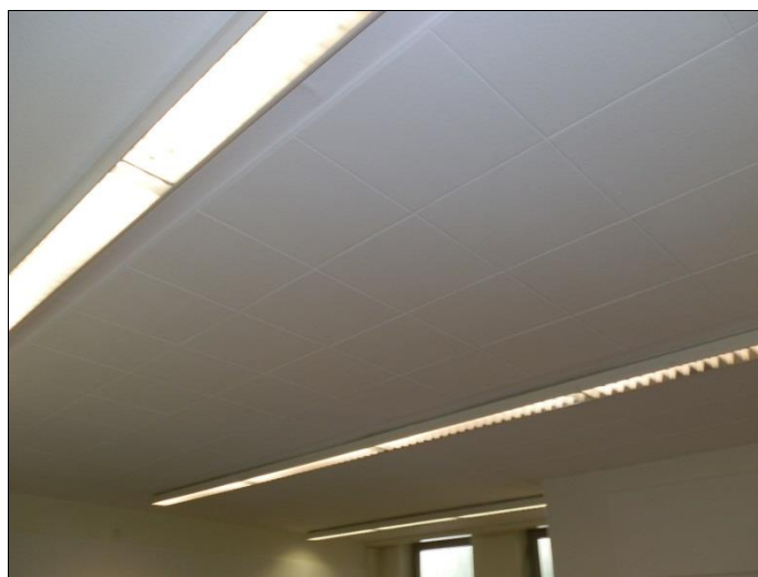
Schulküche/Rasterleuchten mit T8-Leuchtstofflampen und EVG
