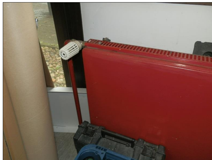
Hauptgebäude/Heizkörper mit Thermostatventil ohne Voreinstellung
