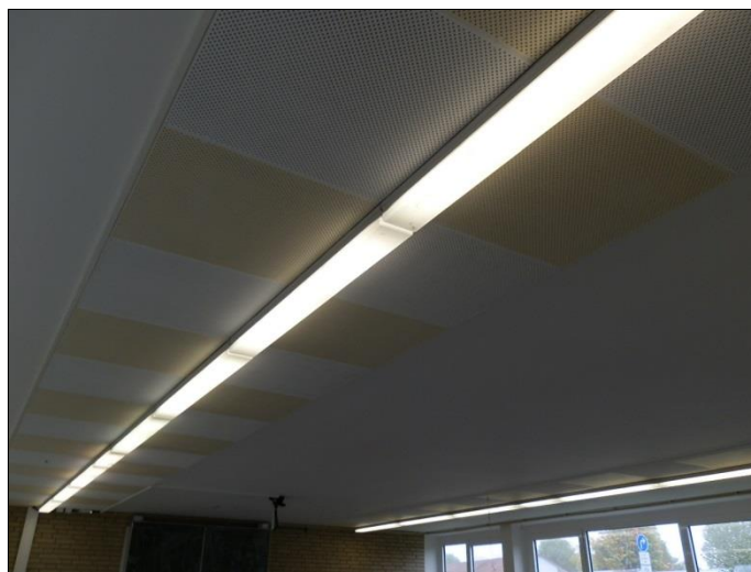
Hauptgebäude – Klassenraum/alte Anbauleuchten mit Opalabdeckung
