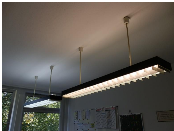
EG/Schulleiterzimmer, alte Rasterleuchten
