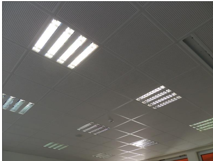
T5-Leuchten mit Bedarfssteuerung über Präsenzmelder
