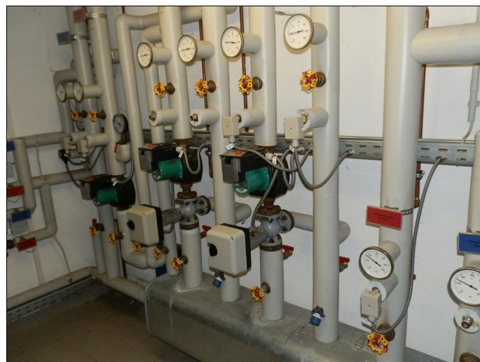
8-Klassen-Bau / Heizungsverteiler und Umwälzpumpen BA 2
