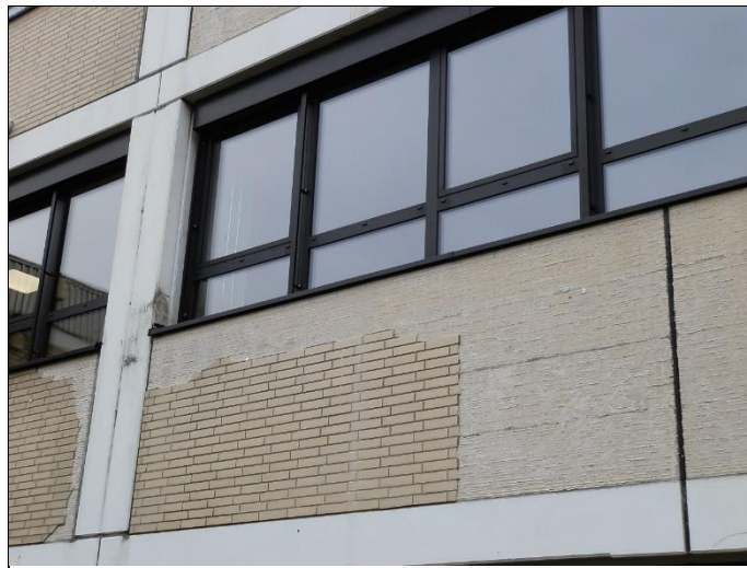
Schäden an der Fassade/fehlende Verklinkerung
