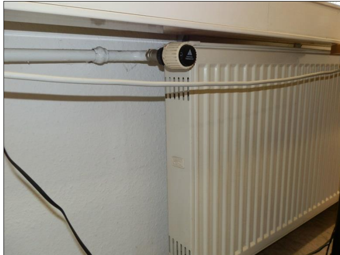
Altbau/Radiator mit Thermostatventil, nicht voreinstellbar
