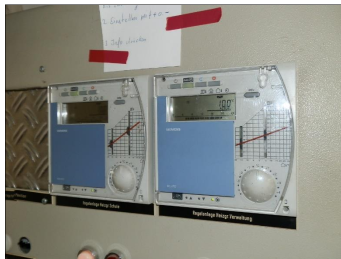
Regelgeräte im Heizraum
