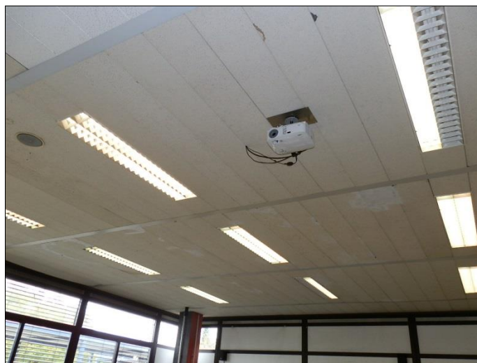
Hauptgebäude – Klassenraum/alte Einbauleuchten mit T8-Lampen und KVG
