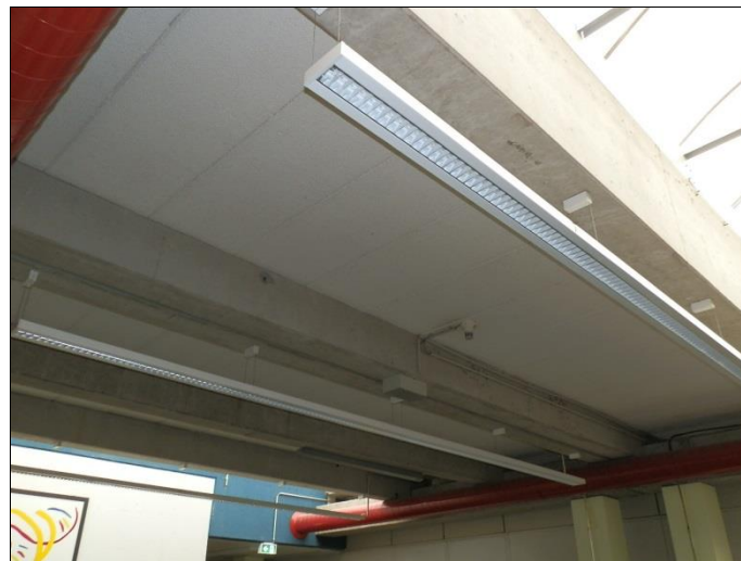
Hauptgebäude – Flur 1. OG/T5-Leuchten mit EVG
