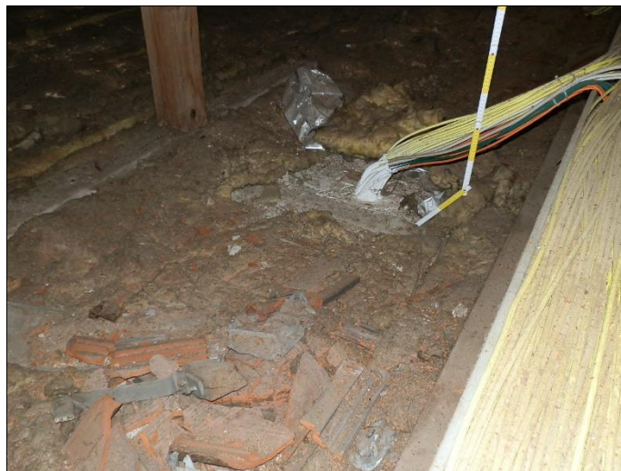
Alte und schadhafte Dämmung der obersten Geschossdecke
