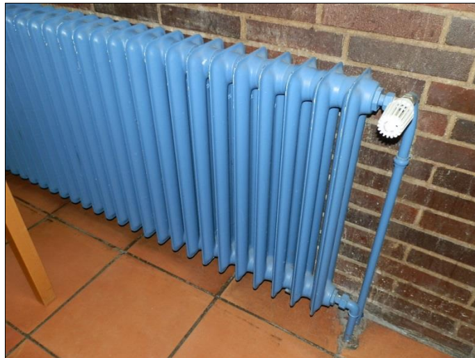
Heizkörper mit festeingestelltem Thermostatventil
