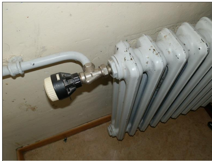
Heizkörper mit Thermostatventil
