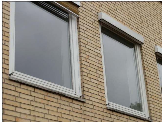
Isolierverglasung ca. 1990 bis 1995
