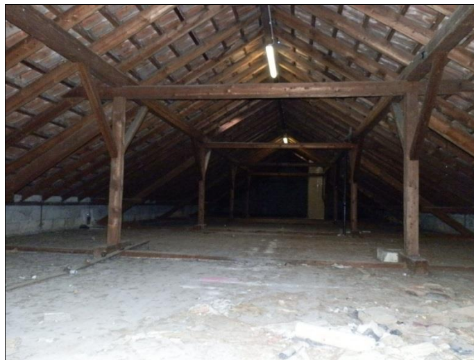
Dach und oberste Geschossdecke ohne Dämmung
