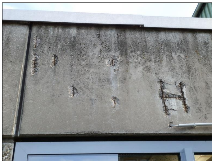
Schäden an der Betonfassade
