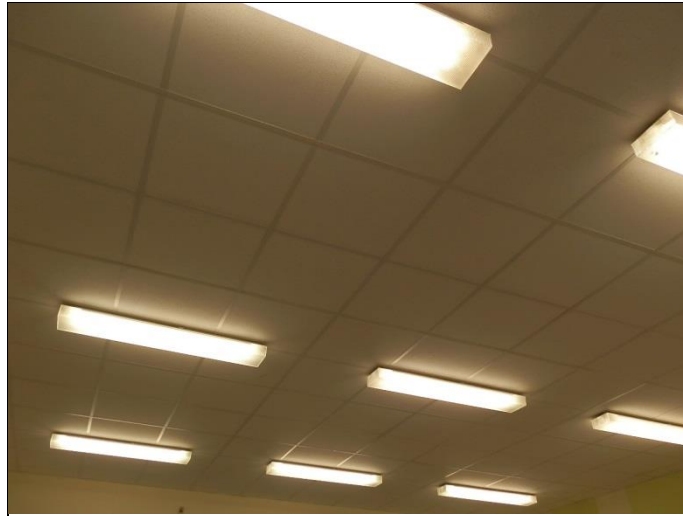
Pavillon / alte Anbauleuchten mit T8-Lampen
