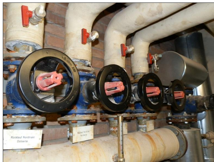
Absperrventile ohne Dämmung
