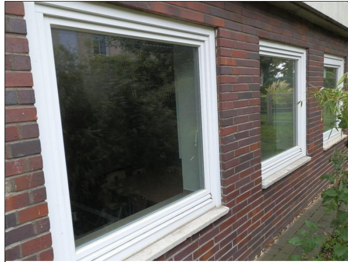
Isolierverglasung ca. 1990 bis 1995
