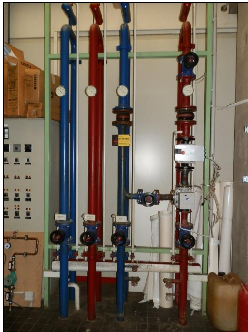
Hauptgebäude/Hocheffizienzpumpe Unterstation Nord
