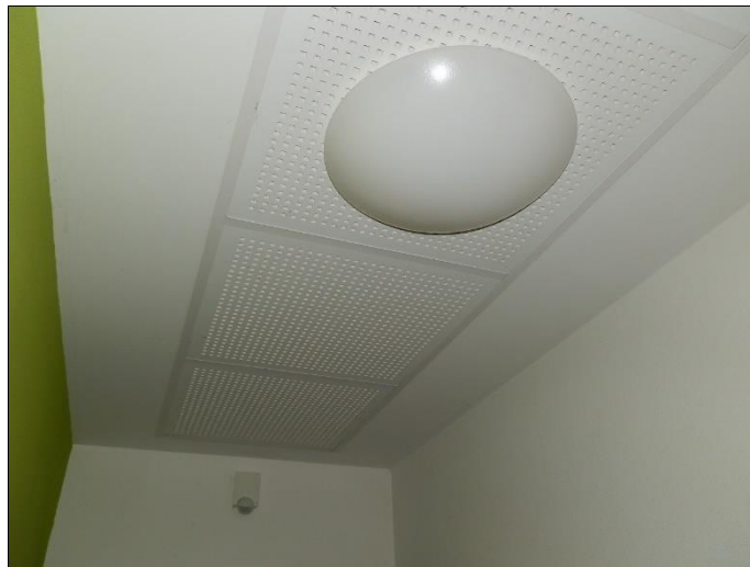
Flur/Leuchten mit Kompaktleuchtstofflampen und Bedarfssteuerung über Präsenzmelder
