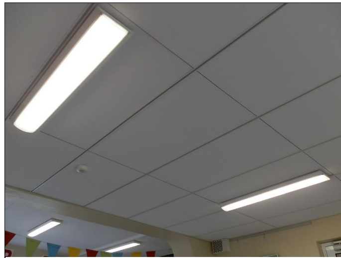
Neue Leuchten mit T5-Lampen und Bedarfssteuerung über Präsenzmelder
