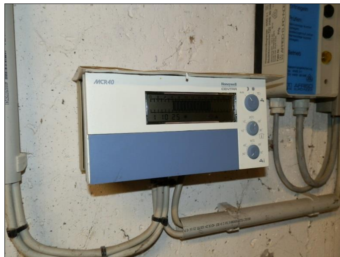
Regelgerät für den Heizkreis Neubau
