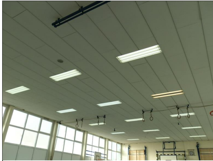
Hallenbeleuchtung mit T8-Lampen und EVG
