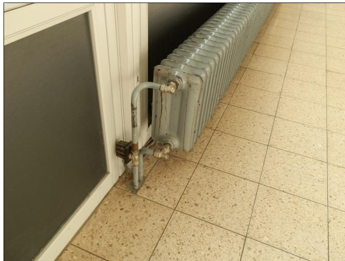
Altbau/Heizkörper mit elektronischem Heizkörperventil und Rücklaufverschraubung
