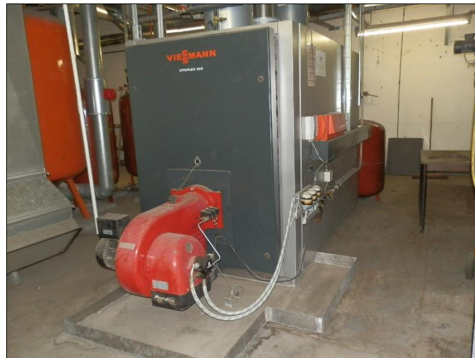
Niedertemperaturkessel mit Heizölfuerung
