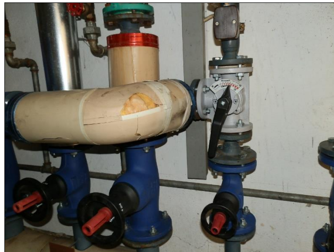
Heizung – Nebenräume/Dreiwege-Mischer ohne elektrischen Stellantrieb
