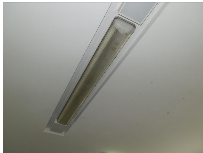
Flur/Aufbauleuchte mit T5-Lampen und EVG
