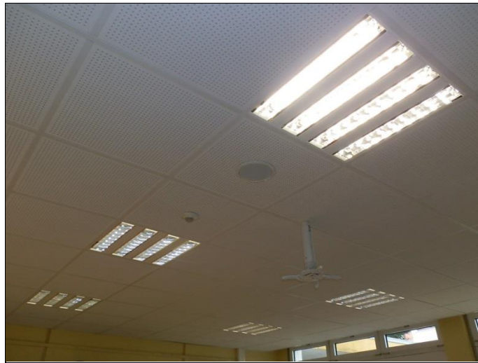
Hauptgebäude / Einbauleuchten mit T5-Leuchtstofflampen, EVG und Bedarfssteuerung über Präsenzmelder
