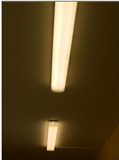
Altbau - Kopierraum/alte Anbauleuchten
