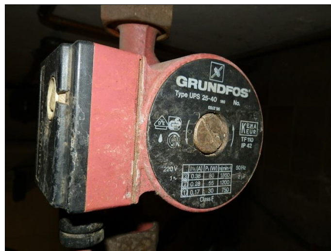
Veraltete, unregelte Umwälzpumpe
