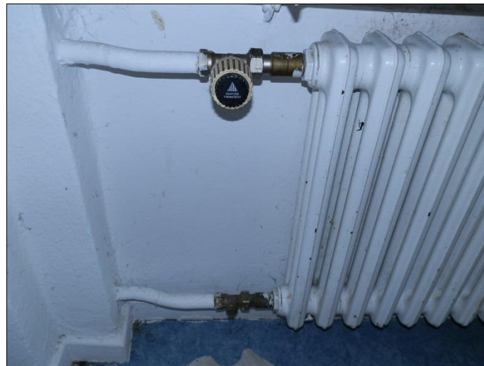
Heizkörper mit altem Thermostatventil
