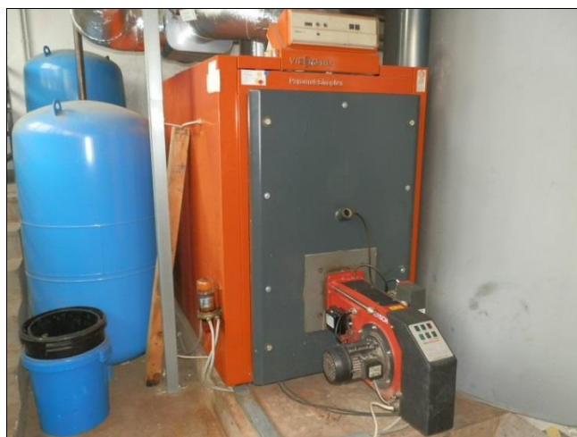
Kessel mit Heizölfеuerung
