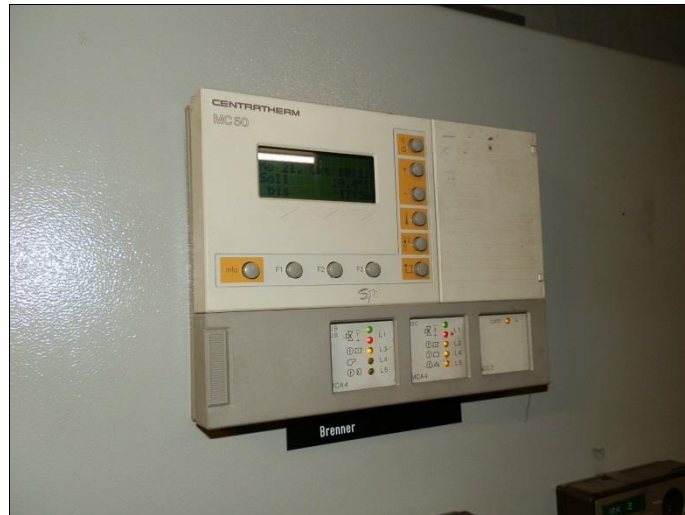
Regelgerät für die Heizkreise Altbau und Hauptgebäude
