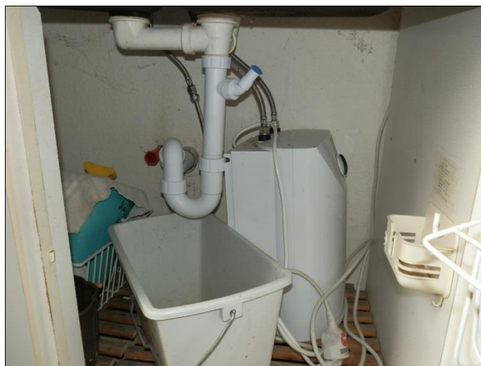
Dezentrale, elektrische Trinkwarmwasserbereitung
