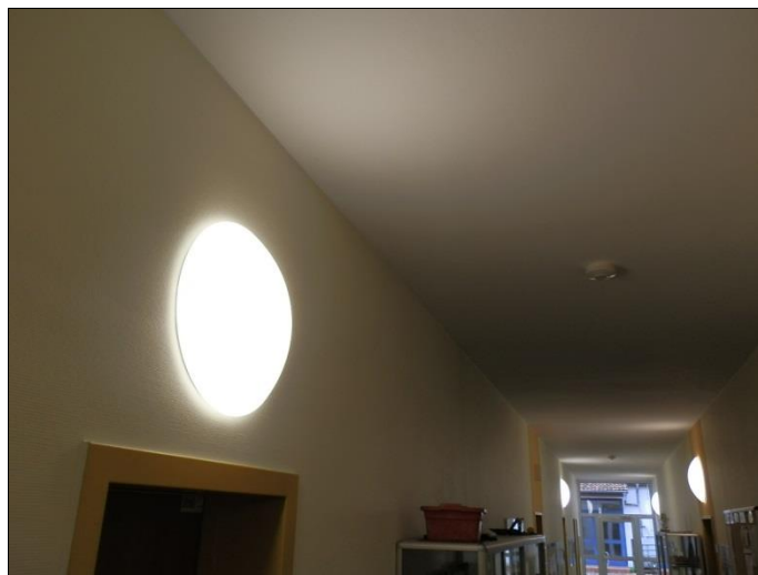
Verwaltung / Leuchten mit Kompaktleuchtstofflampen und Präsenzmelder
