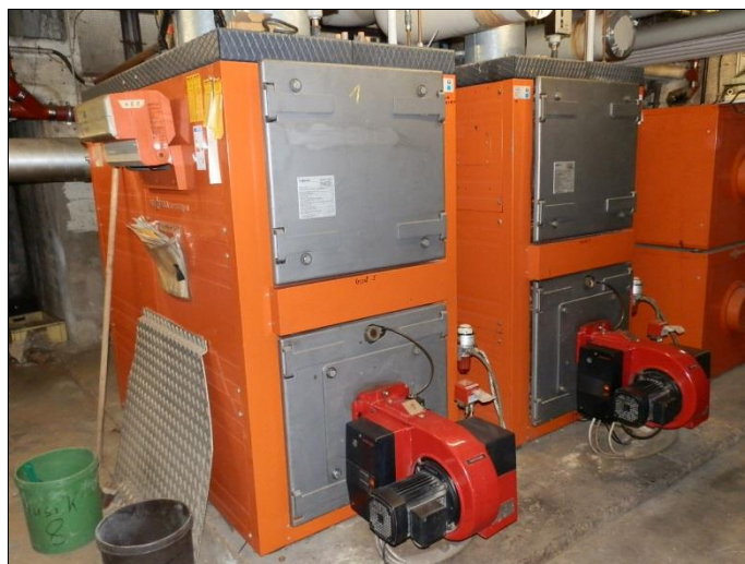
Veraltete Kesselanlage und Warmwasserbereiter
