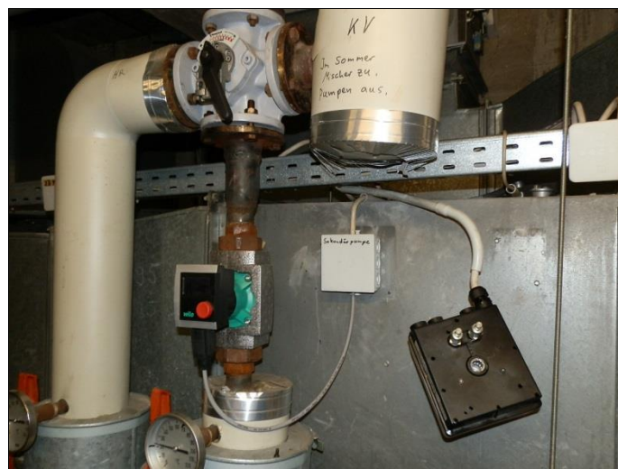
RLT-Anlage Halle/defekte Regeltechnik, demontierter Stellantrieb
