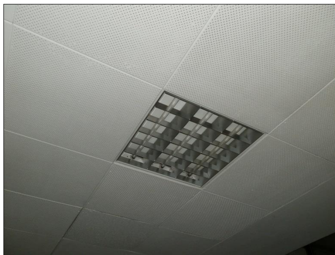
Flur 1. OG/veraltete Einbauleuchte
