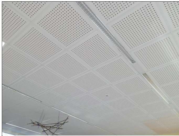
Hauptgebäude – Klassenraum / neue T5-Leuchten mit Bedarfssteuerung über Präsenzmelder
