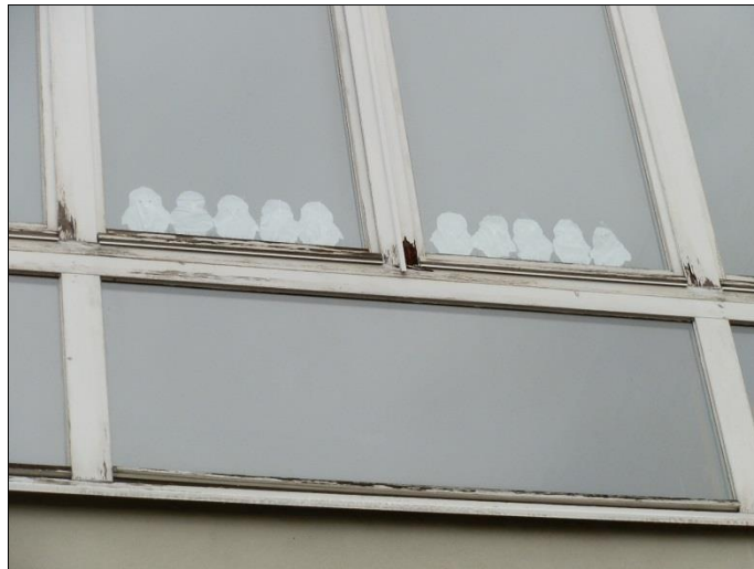
Fenster mit z.T. schadhaften, veralteten Holzrahmen
