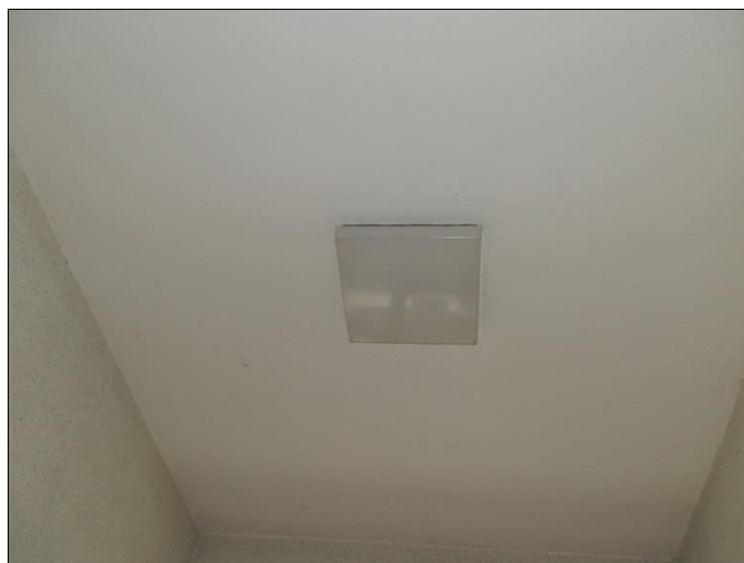
Altbau / veraltete Anbauleuchten mit Glühlampen
