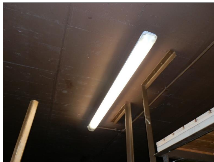
Geräteraum/Anbauleuchte mit T5-Lampe
