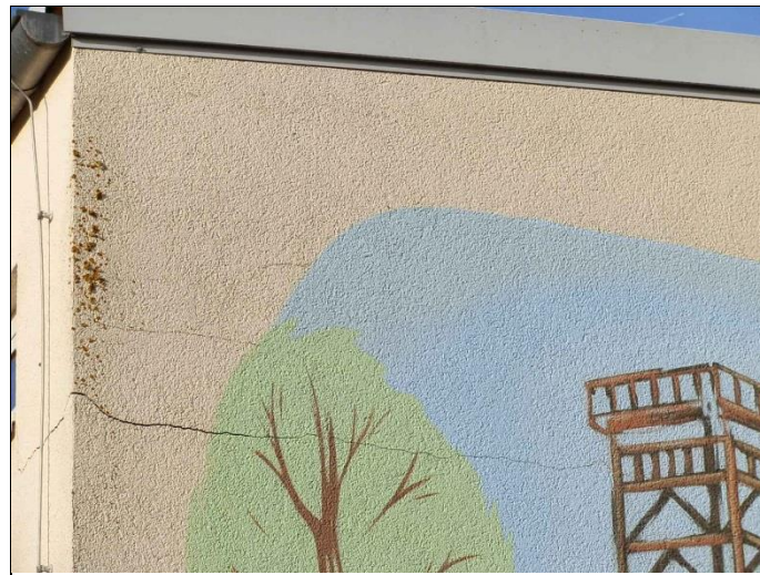
Risse an der Fassade
