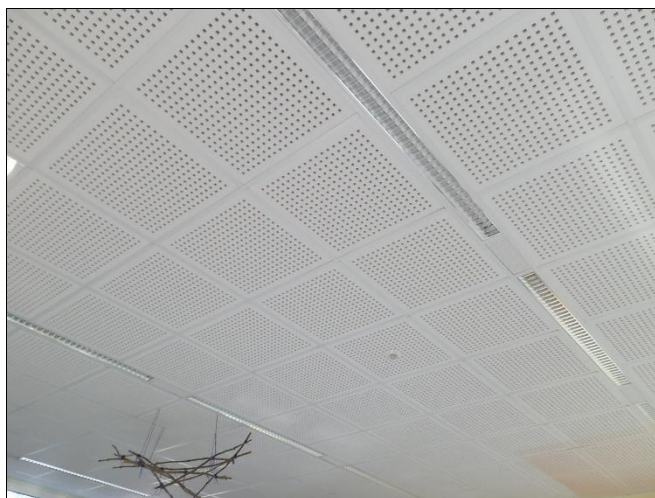
Hauptgebäude/Klassenraum mit T5-Lampen und Präsenzmelder
