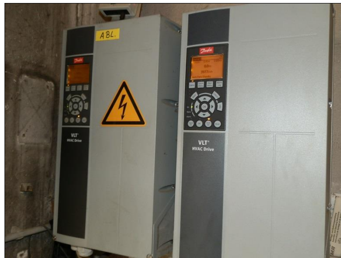
Frequenzumformer zur Drehzahlregelung der Ventilatorantriebe
