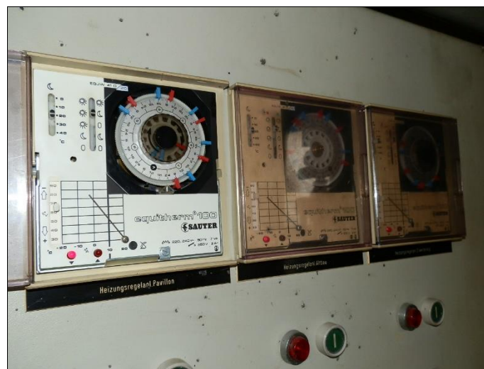
Veraltete, defekte Regeltechnik
