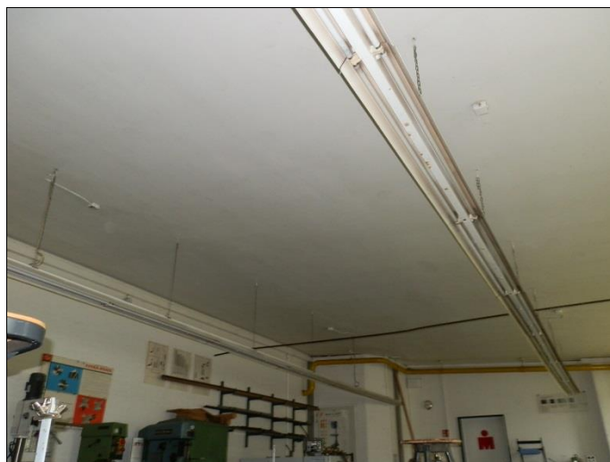
Altbau – Metallwerkstatt/veraltete Leuchten mit T8-Lampen
