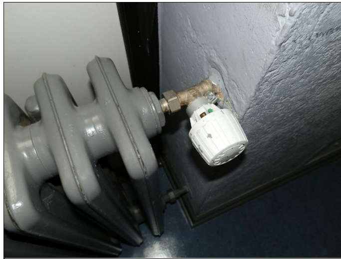
Heizkörper mit Thermostatventil ohne Voreinstellung
