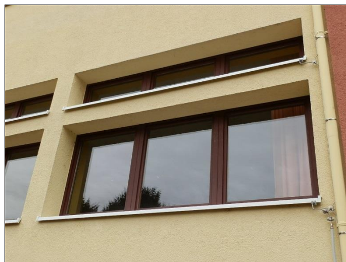
Wärmeschutzverglasung mit Holzrahmen
