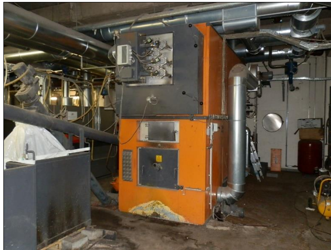
Kessel mit Holzhackfeuerung
