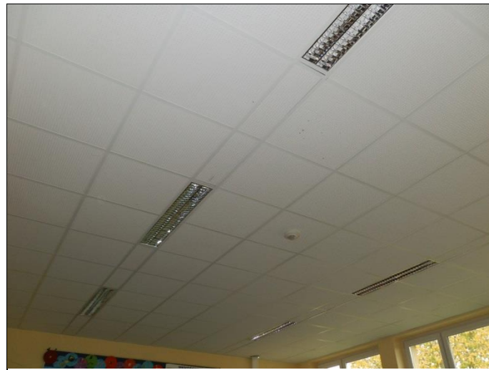
Altbau/Klassenraum, Einbauleuchten mit T5-Lampen
