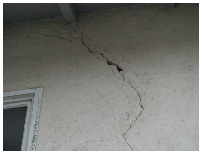
Risse an der Fassade
