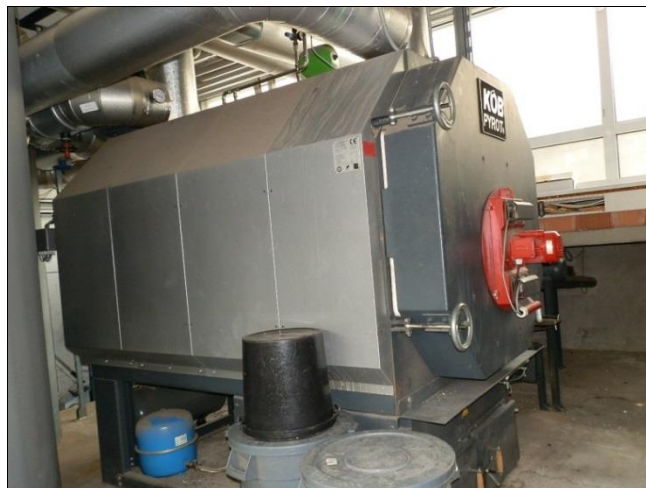
Kessel mit Pelletsfeuerung
