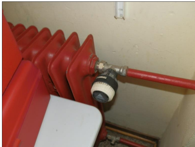
Altbau / Thermostatventil ohne Voreinstellung
