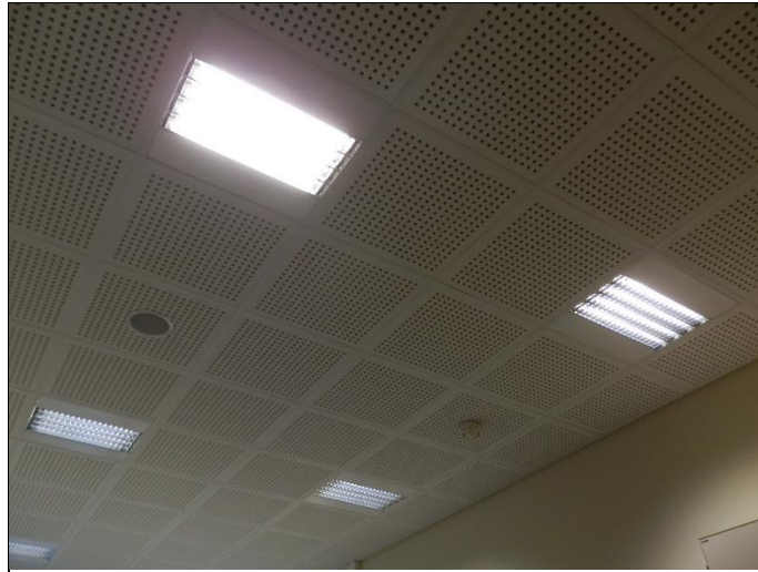
Klassenraum/neue Leuchten mit T5-Lampen
