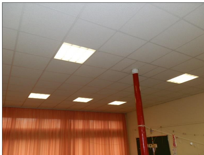
Altbau / Einbau-Rasterleuchten mit T8-Lampen
