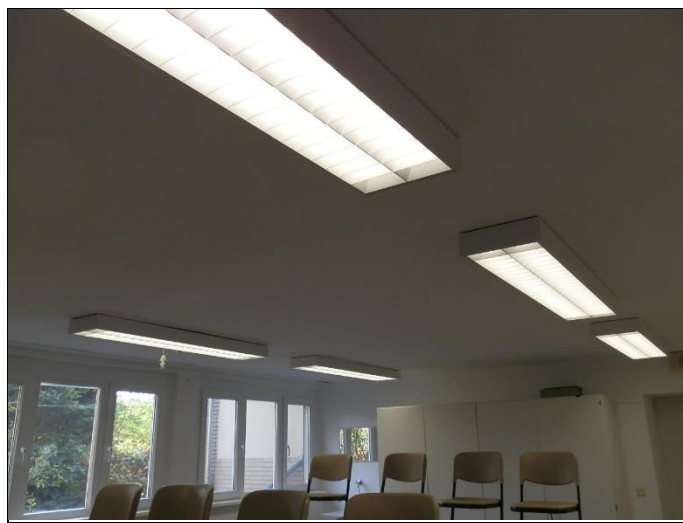
Hauptgebäude/Klassenraum EG, alte Raster-Anbauleuchten
