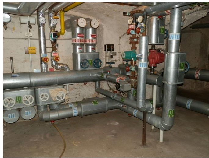
Altbau / Heizungsverteiler und Umwälzpumpen
