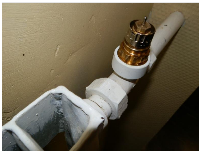
Hauptgebäude / Thermostatventil mit Voreinstellung, nicht einreguliert
