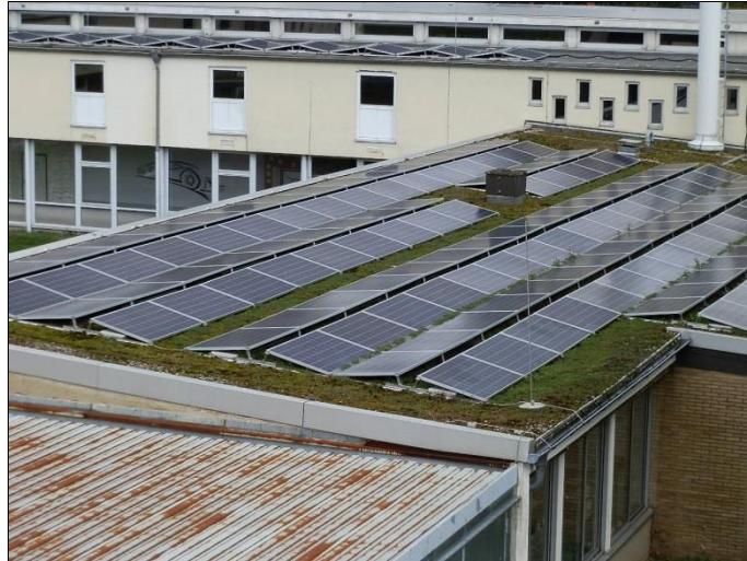
Ansicht Pultdächer mit Photovoltaikanlage
