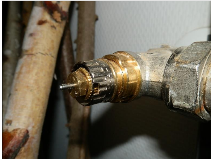
Thermostatventil mit Voreinstellung, nicht einreguliert
