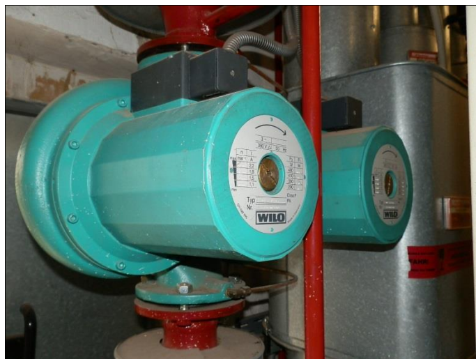
Altbau – Heizzentrale/Fernleitungspumpe, unregelt
