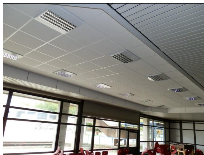
Hauptgebäude – Aula/neue Anbauleuchten
