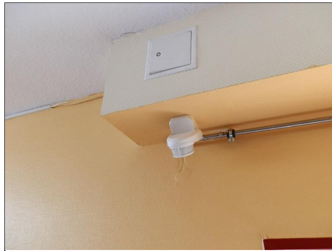
Bedarfssteuerung über Präsenzmelder
