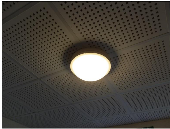
Erweiterungsbau / Leuchten mit Kompaktleuchtstofflampen
