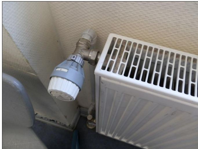
Altbau/Radiator mit Thermostatventil
