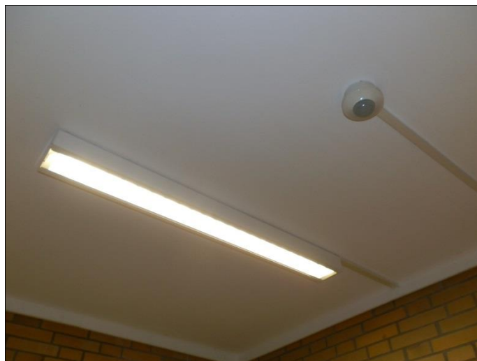
Verwaltung/Leuchten mit T5-Lampen und Bedarfssteuerung über Präsenzmelder
