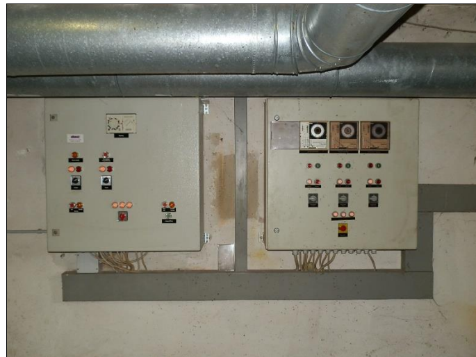
Veraltete, defekte Regeltechnik
