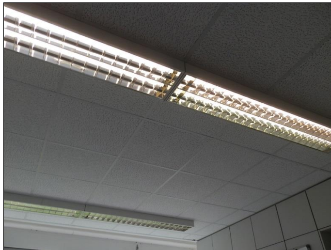
Hauptgebäude/Doppelflammmige Rasterleuchten in der Verwaltung
