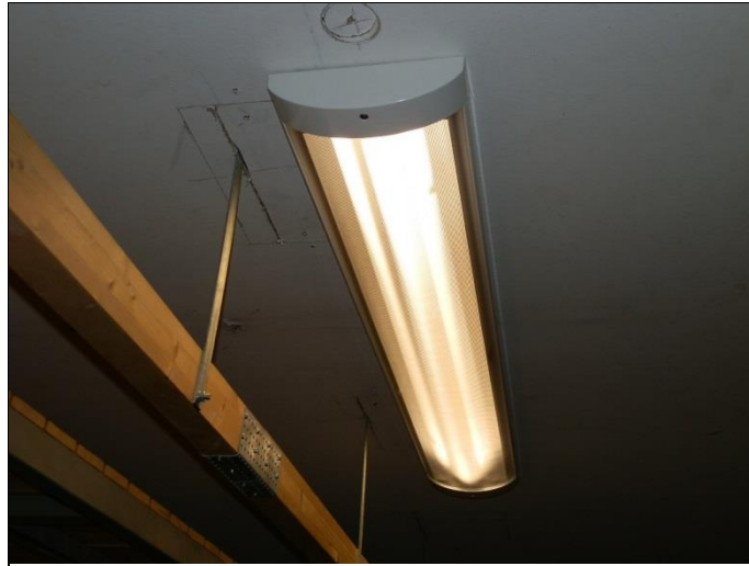
Geräteraum / Aufbauleuchte mit EVG
