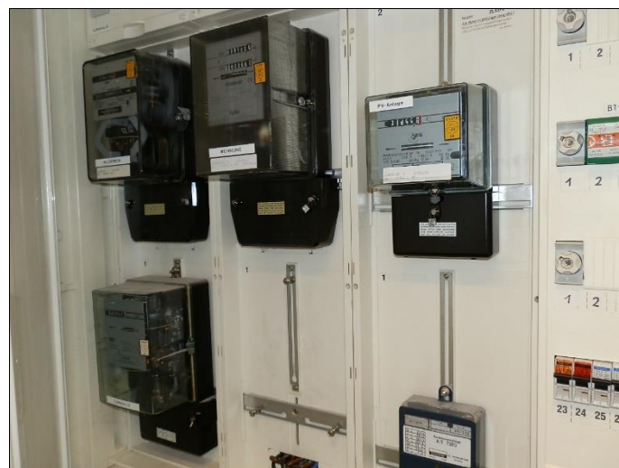
Stromzähler der Objekte und PV-Zähler
