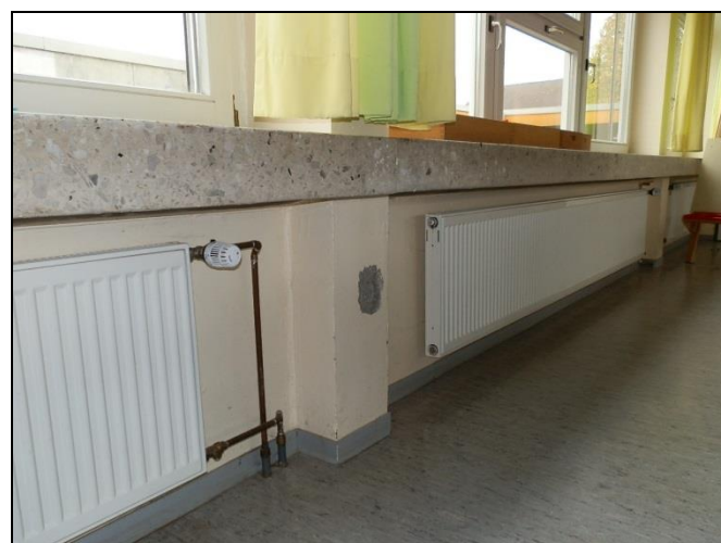
Hauptgebäude/Radiatoren mit Thermostatventilen
