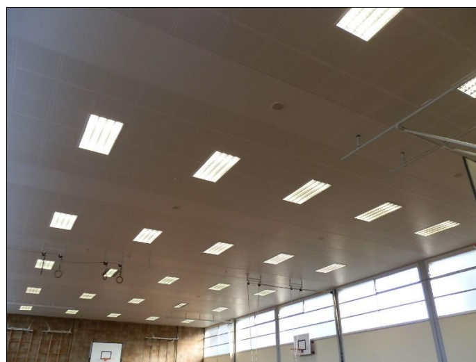
Hallenbeleuchtung mit T5-Lampen und EVG
