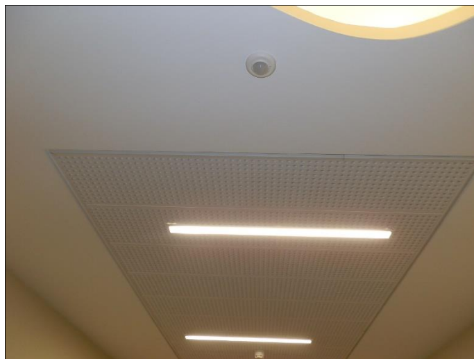
Flur/neue LED-Leuchten mit Bedarfssteuerung über Präsenzmelder
