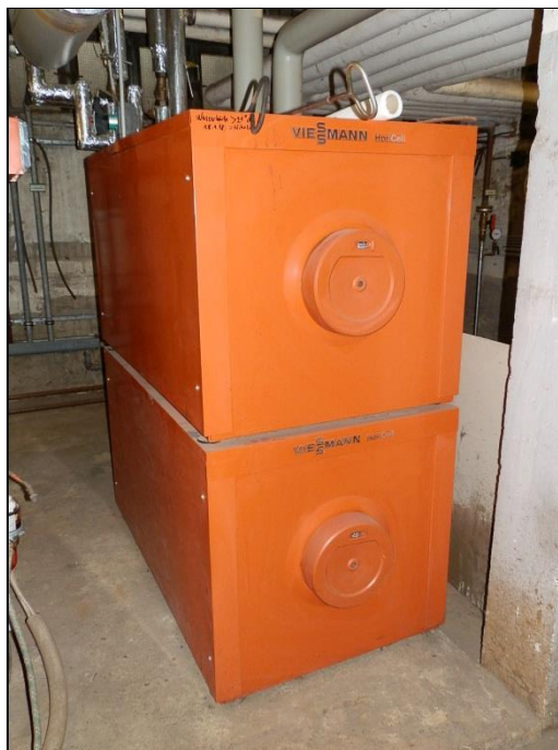
Sporthalle/zentrale Trinkwarmwasser- bereitung
